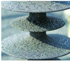
Bild 6. Wassertropfen auf einem verschmutzten RTV-Verbundisolator
