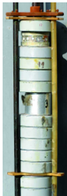
Bild 11. Spuren von Teilentladungen und Rost auf dem Varistorstapel als Folge von Feuchtigkeit
